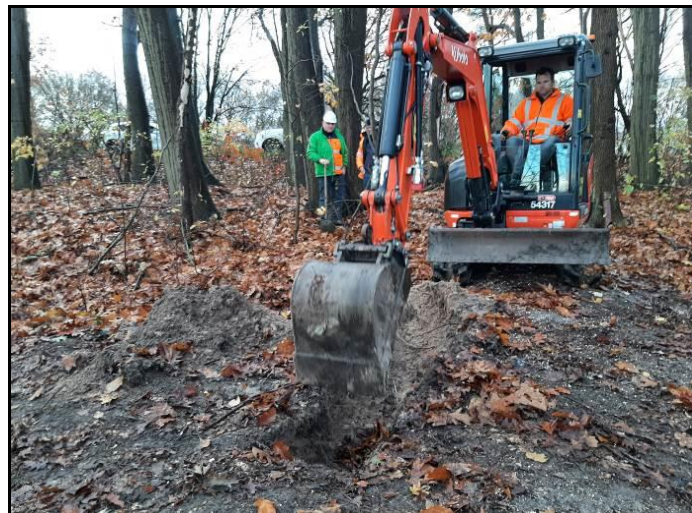
Foto Ton Popelier: nagraven dassenwerk in de dijk van het Drongelens kanaal nabij de roeivijver in Drunen.
