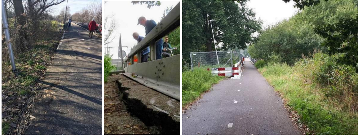
Foto links Bert: het fietspad is aan het verzakken en levert al gevaarlijke situaties op. De gemeente Waalwijk wordt ingelicht. Foto midden André: het fietspad is verder ingestort. Waalwijk heeft veiligheidsmaatregelen genomen. Foto rechts: gemeente Heusden website.
